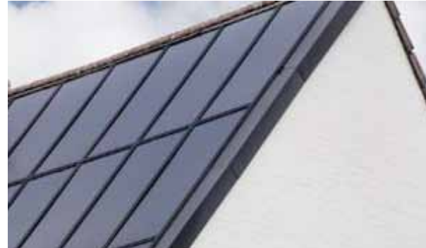
PV geïntegreerd in het dak
